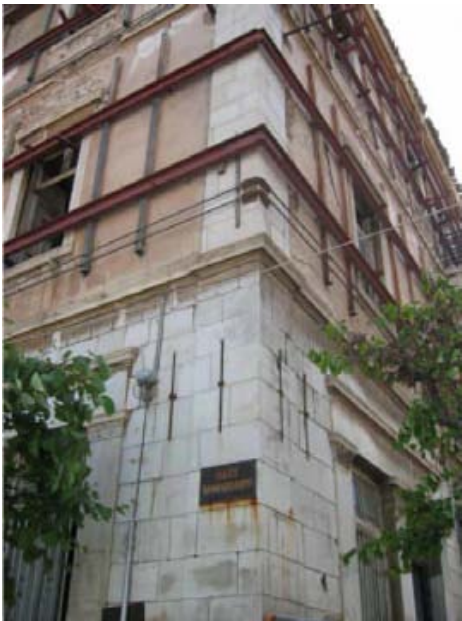
Φωτογραφία 1: Πείροι αγκύρωσης περίδεσης ισογείου. Photograph 1: Horizontal ties at corners
