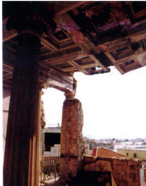
Φωτογραφία 3: Ο πεσσός συγκρατήθηκε από τη δοκό. Photograph 3: Internal view of collapsed region.
