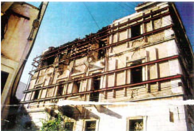
Φωτογραφία 2: Άποψη της νότιας όψης του κτιρίου. Διακρίνεται η περιοχή κατάρρευσης.
