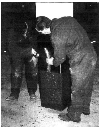
Σχήμα 6.1 Ενίσχυση υποστρώματος με μανδύα σύνθετων υλικών σε υπόγειο χώρο στάθμευσης αυτοκινήτων, Δουβλίνο, Ιρλανδία.
